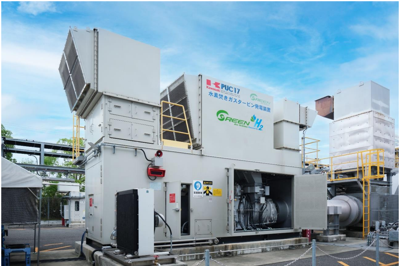
写真 8 ポートアイランドの水素 CGS エネルギーセンターにある水素ガスタービン発電装置
