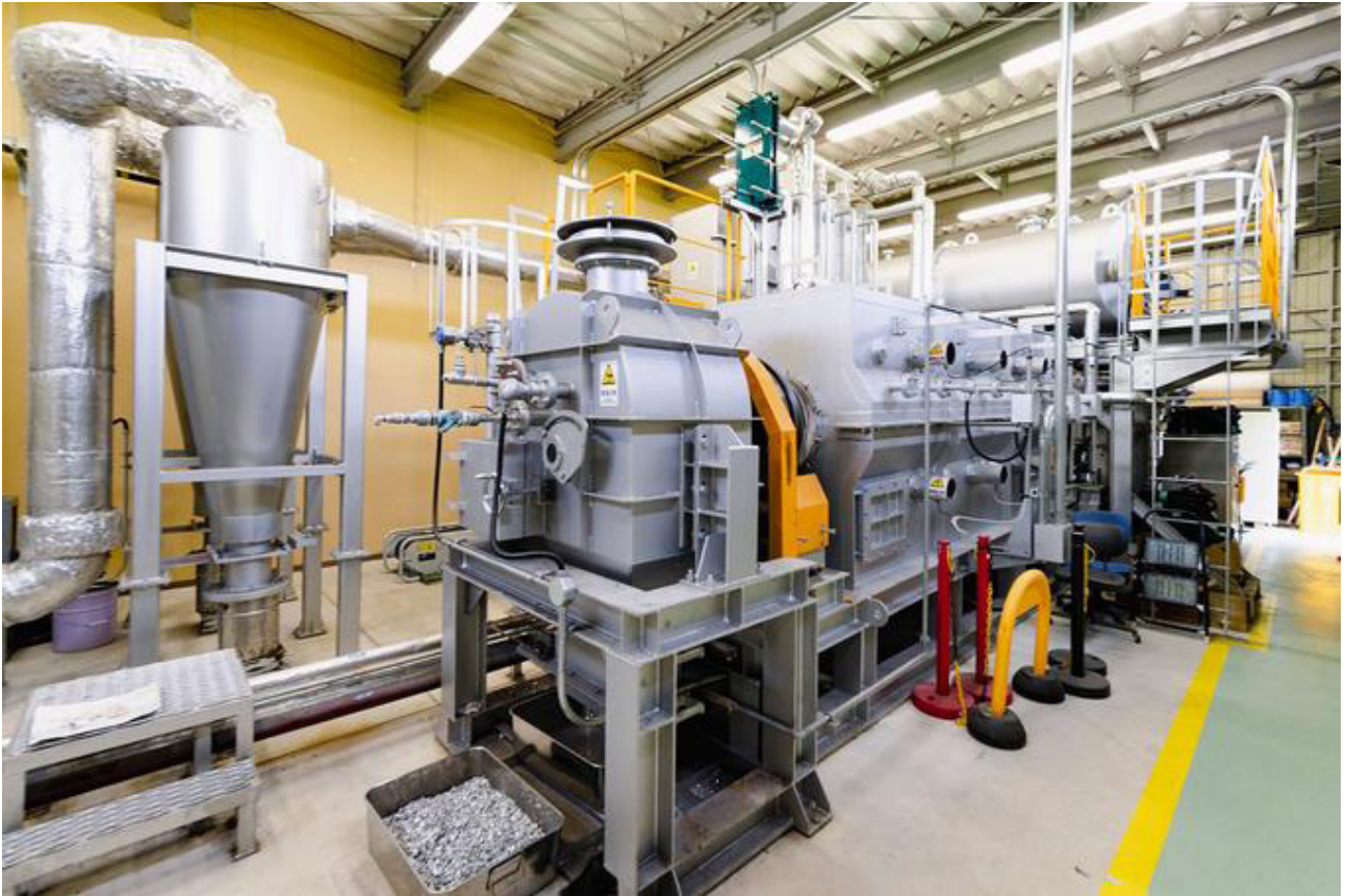
写真 7 乾留炉（乾留式アルミ回収装置）
