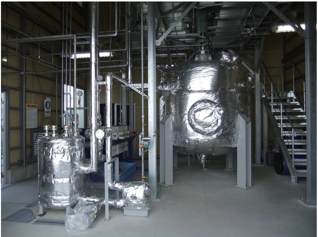
写真9 水素製造装置（資料提供：アルハイテック株式会社）
