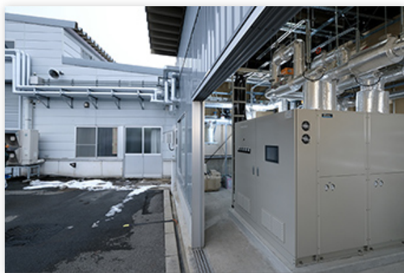
写真6 新システムの機器室とそこからZEB化建物へと続くパイプ群 (写真左奥)。
