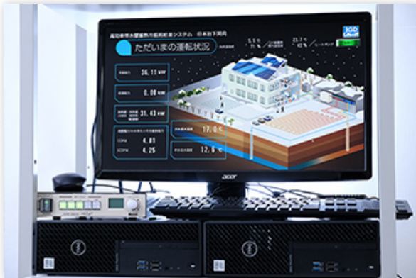
写真7 (上) 給湯も可能となった新ヒートポンプと (下) システムの稼働状況モニター
