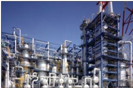
新触媒が使用されているコスモ石油の脱硫プラント
