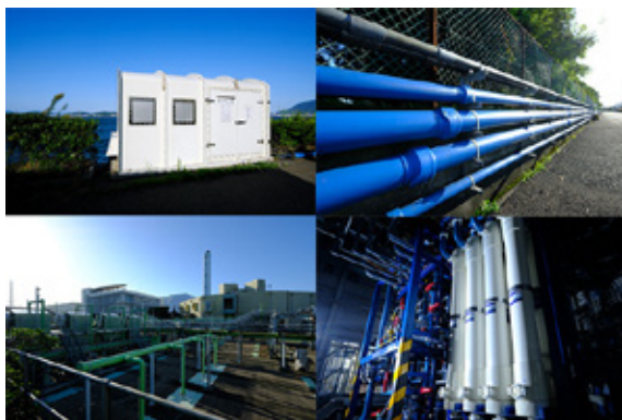
写真 2 北九州市小倉北区西港町にある「ウォータープラザ北九州」。関門海峡に面した海水取水口（上段左）、取水された海水（上段右）は隣接する下水処理場（下段左）の脇を通過して、新プラントの前処理行程へ（下段右）、この工程後、海水は下水処理工程からの排水で希釈される
