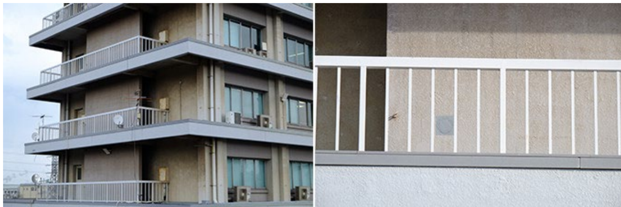
写真6 福岡県北九州市に50年前に実験的に建設された高炉セメントによるビル（左）、柵の向こうの灰色の四角い部分から耐久性を検査するコアを抜いた
