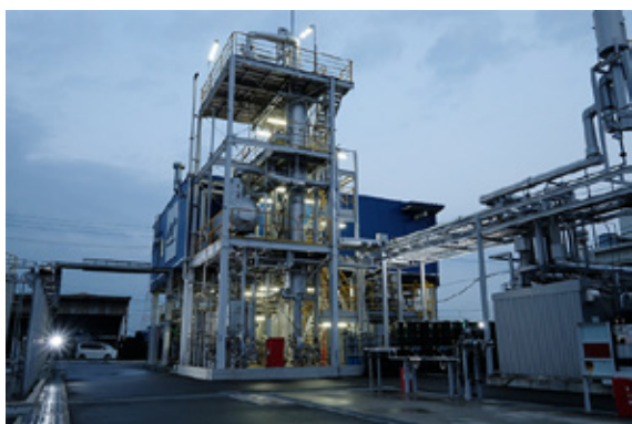
写真 5 住之江プラントの外観
