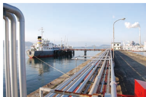
図10 港から通じる高圧ガスのパイプライン 輸送コストが低減できる (提供：日本ゼオン)
