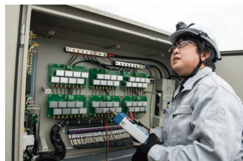
図7 メガソーラーで導入されているSOKODES（ソコデス）のしくみについて説明する松尾さん
