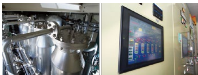
左・不純物の吸着と脱着を繰り返し、水素の純度を上げる 圧力スイング吸着装置(PSA)、 右・5塔のPSAを切り替え、その状況を示す制御盤
