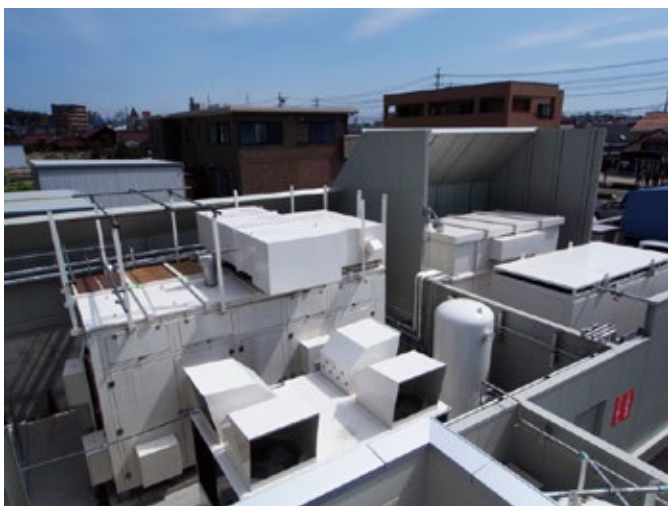
神の倉水素ステーションの一角に設置された HyGeia-A(奥の装置)
