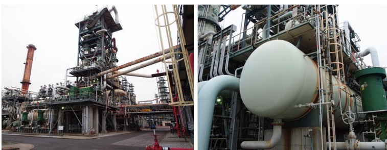
(左) 低位熱発電システム (右) 作動流体に使用するアンモニア貯蔵槽
