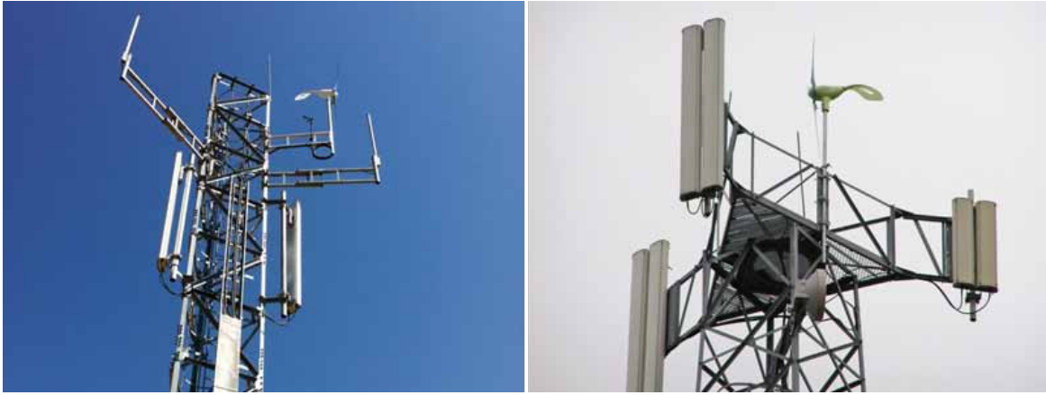
海外の携帯電話基地局の独立電源として設置されているエアドルフィン、 左はアフリカナミビア、右はトルコの携帯電話会社の基地局（画像提供・ゼファー株式会社）
