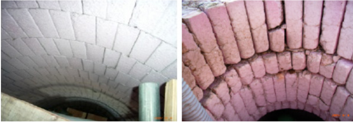
腐食前の燃烧炉内のレンガ（左）とフッ化水素による腐食が進んだレンガ（右）
