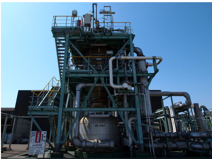
旭硝子千葉工場内に設置された 月島環境エンジニアリング製の「フロン類破壊装置」
