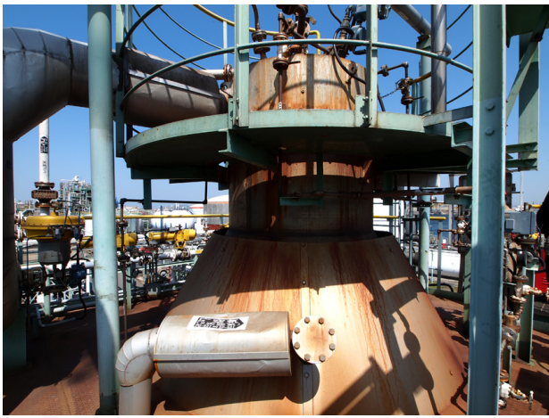
燃焼炉上部のバーナー部分
