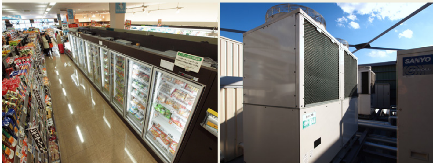
( 左 ) 店舗内の冷凍ショーケース、( 右 ) 店舗の屋上に設置されたノンフロン冷凍機
