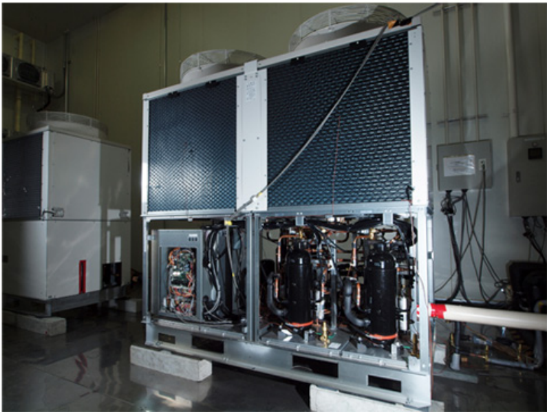
ノンフロン冷凍機システムの仕様（左表）と CO 2 冷凍機
