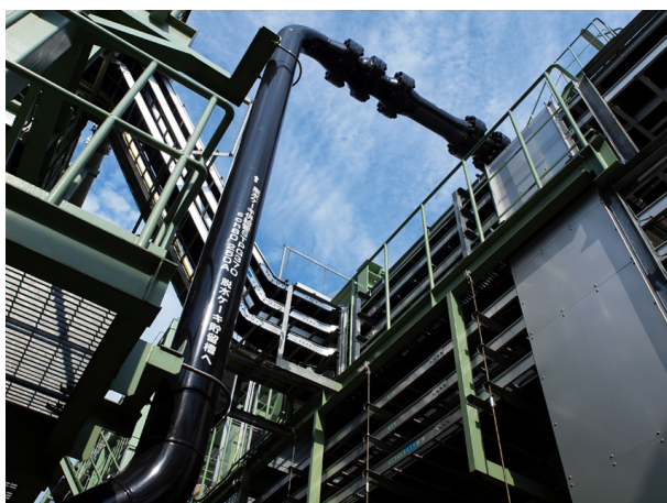
脱水汚泥をガス化炉に送り込む供給管
