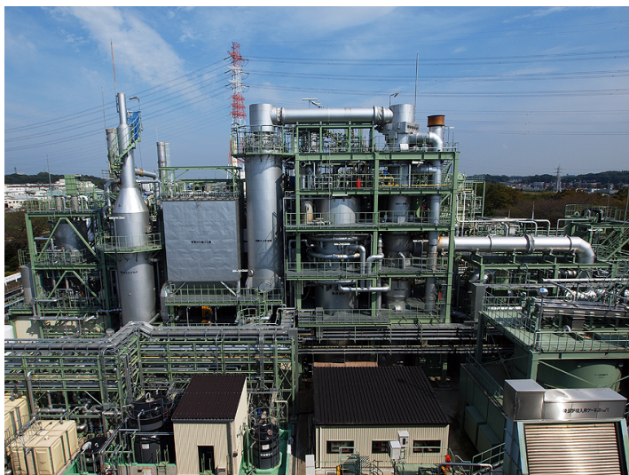
下水汚泥ガス化発電システムの全景
