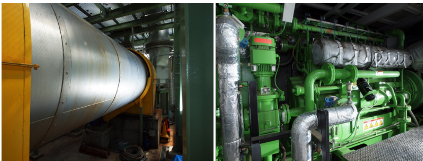
廃熱を利用した汚泥乾燥機（左）と、ガスエンジン（右）
