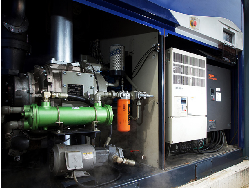
スチームスター内部。左側の上部からパイプがつながった部分がスクリー格納部。 右側は、インバータや制御機器
