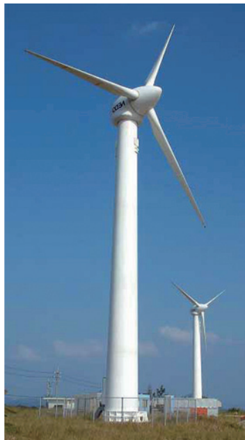
40kW 風車 ( 左 ) と 100kW 風車 ( 右 )
