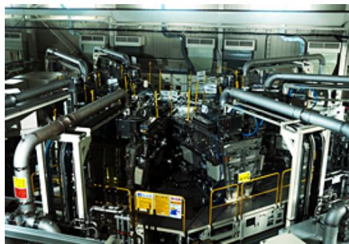
長崎県諫早市の長崎造船所内にあるアモルファスシリコン太陽電池製造用のプラズマCVD装置。星形なのは、直列でラインを長くしないためと、ラインの1工程がストップしても影響を最小限にするため
