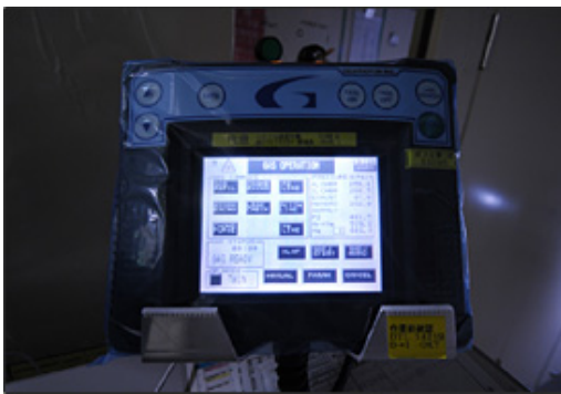
光源発生装置の制御盤
